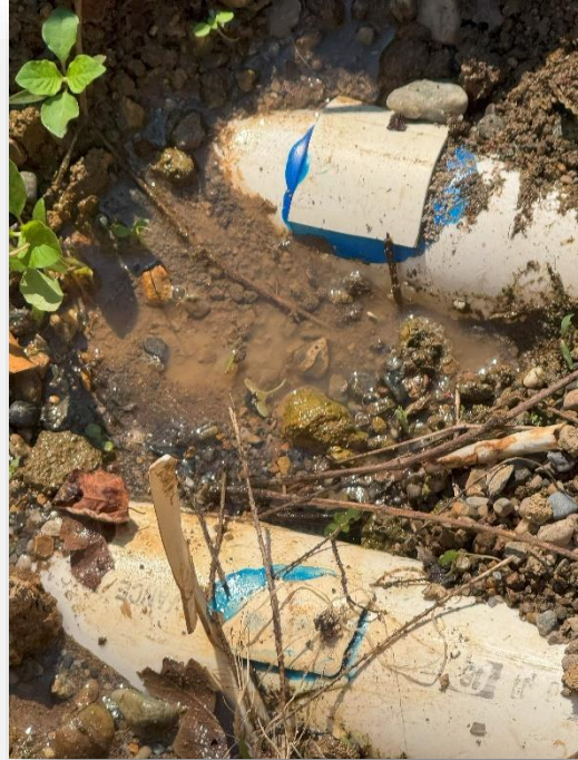
San José Independencia, Tuxtepec. 19 (Agua Potable, fuente propia)
