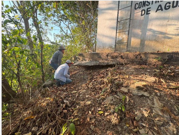
San José Independencia, Tuxtepec. 21 (Agua Potable, fuente propia)
