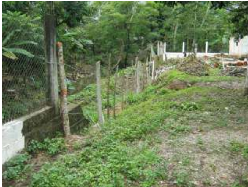
Figura 56. La inundación rompió la barda perimetral de la escuela primaria Benito Juárez el 8 de Julio de 1998.
